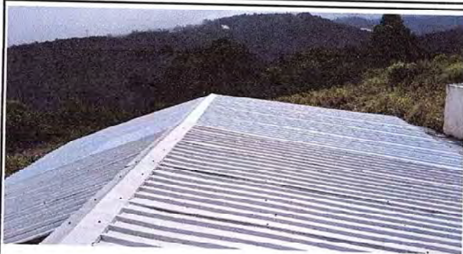
Foto 1: Vista Actual del techo aula numero 10.
